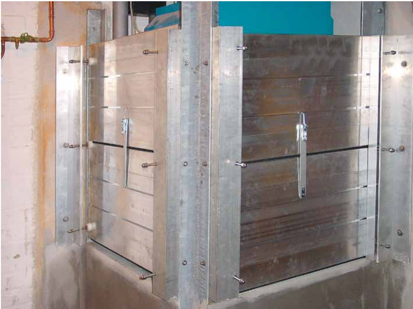
Sicherung eines Heizbrenners
